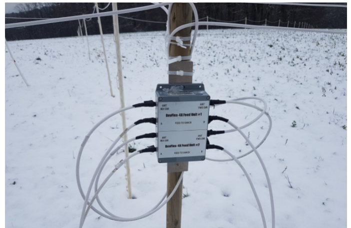
Auch die Beverages lassen sich parallel von beiden Stationen nutzen.
