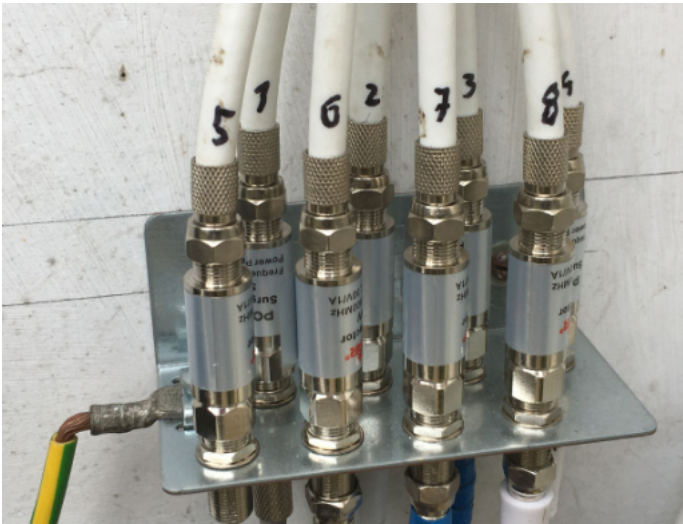
Fertiger Aufbau im Verteilerschrank mit Ableiter der Firma Poppstar
