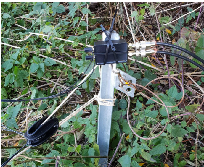
Bild 3 Beverage-Einspeisung mit Hardware von KD9SV
